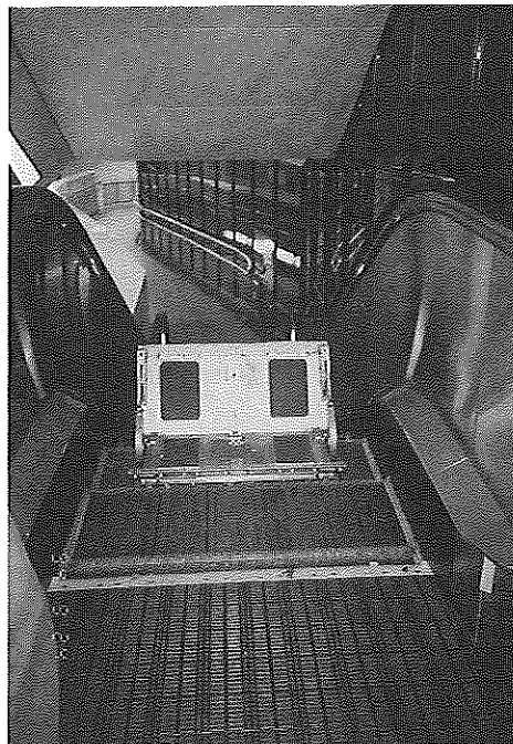
(写真3) 車いす乗用ステップ付エスカレーター(新宿西口)
